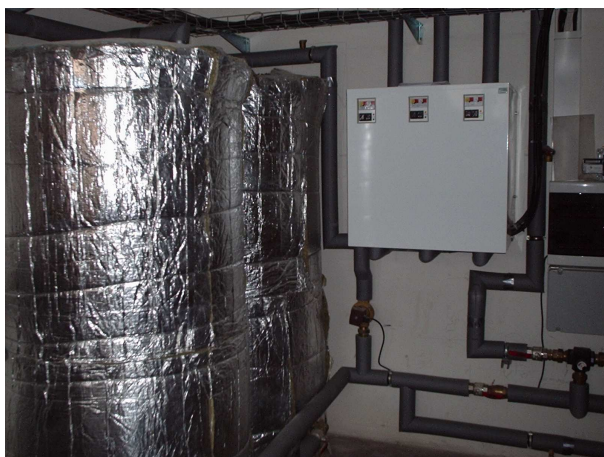
Akumulační nádrže a elektrokotel
